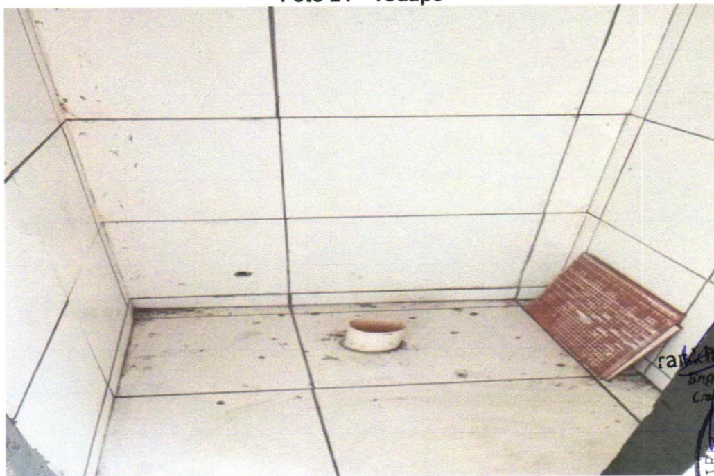
Foto 22- revestimento na parede
