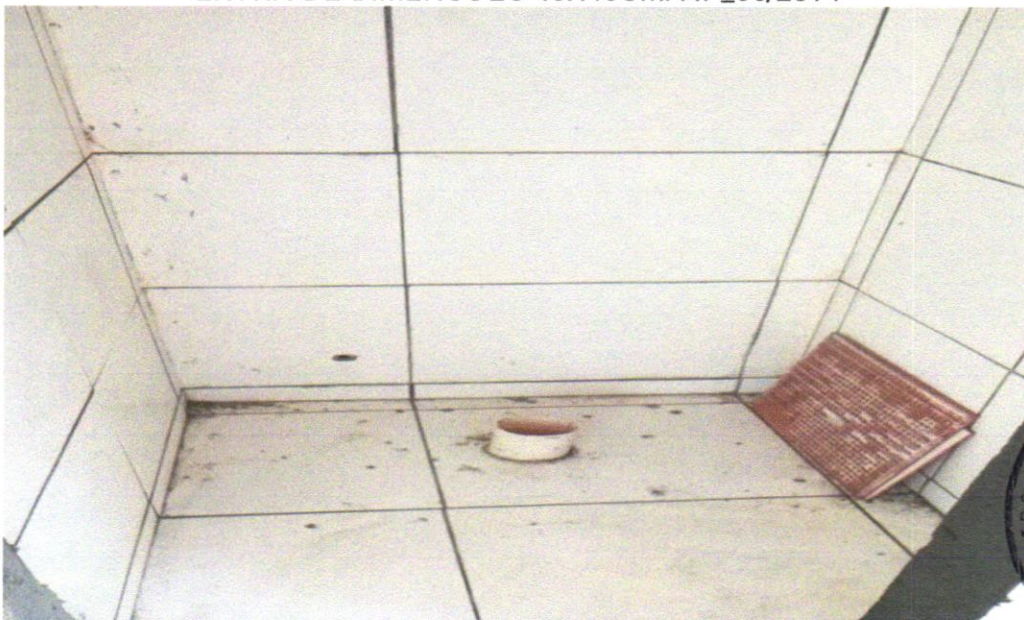
Foto 22- REVESTIMENTO CERÂMICO PARA PAREDES INTERNAS COM PLACAS TIPO ESMALTADA EXTRA DE DIMENSÕES 33X45CM APLICADAS EM AMBIENTES DE ÁREA MAIOR QUE 5M2 A MEIA ALTURA DAS PAREDES. AF_06/2014
